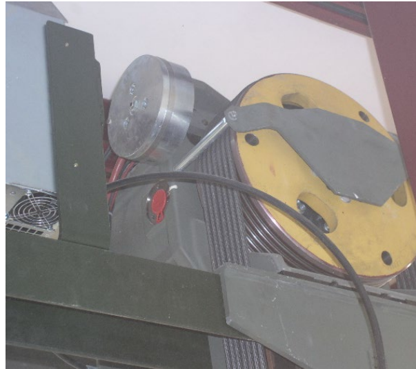
Frequenzumrichter und Synchron-Gearlessmaschine
